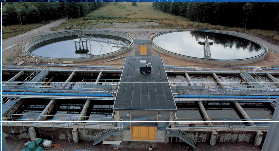
Установка водоочистки в Порво (Финляндия)
